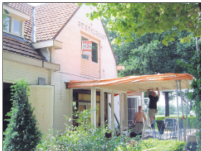
Werklui zijn bezig met de betimmering van de houten entree. Restaurant De Vossenkleem krijgt een eigentijdse uitstraling.
